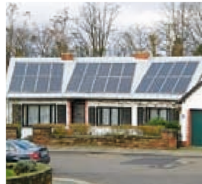
Mehrfamilienhaus in Saarbrücken Photovoltaik-Anlage 32 kWp zur Stromerzeugung
