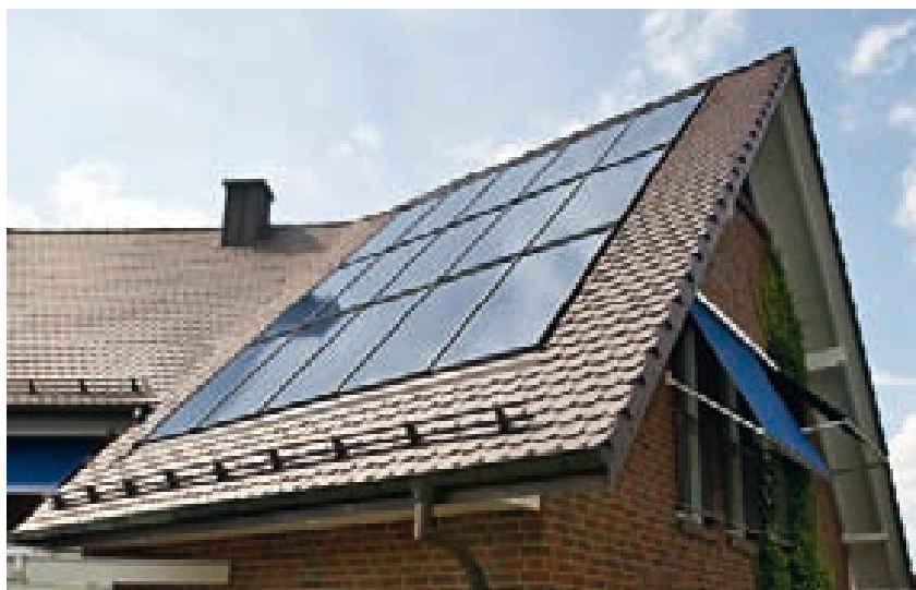
Wohnhaus in Vechta Solaranlage 19,2 m 2 zur Trinkwassererwärmung und Heizungsunterstützung in Kombination mit 5,7 kWp Photovoltaik
